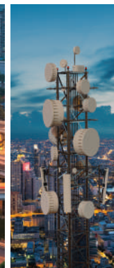
Telecom & Network โทรคมนาคม
